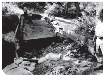
水道管も崩壊した 佐摩地区の新佐摩橋
