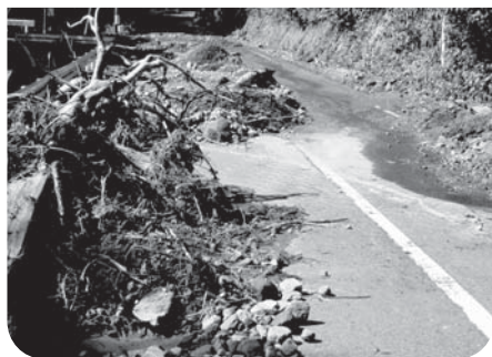
土砂崩れで 通行止めの赤松河原線
