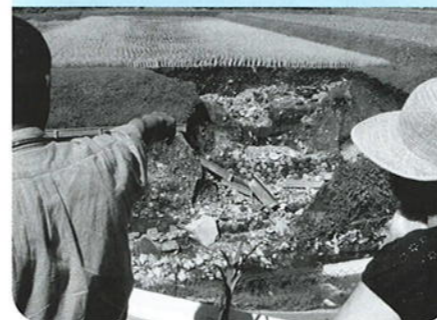
水路も崩壊した 赤松地区の水田
