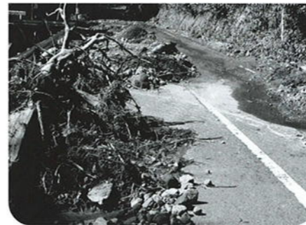
土砂崩れで 通行止めの赤松河原線
