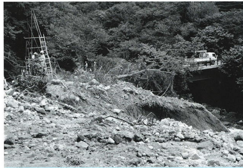
台風12号で崩壊した県道「川床橋」付近
