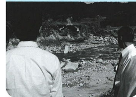
橋がすべて崩壊した 阿弥陀川の坊領東橋
