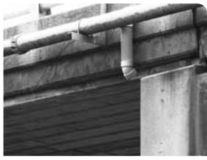
こわれた路面排水設備
