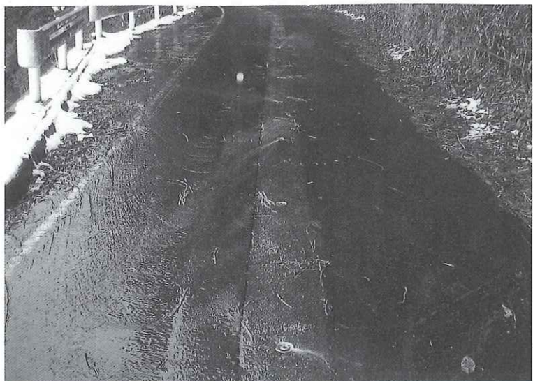
水が吹き出る消雪設備(道路中央)
