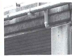
こわれた路面排水設備
