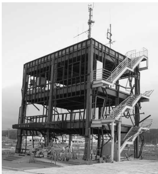
被害を受けた防災庁舎(南三陸町)
