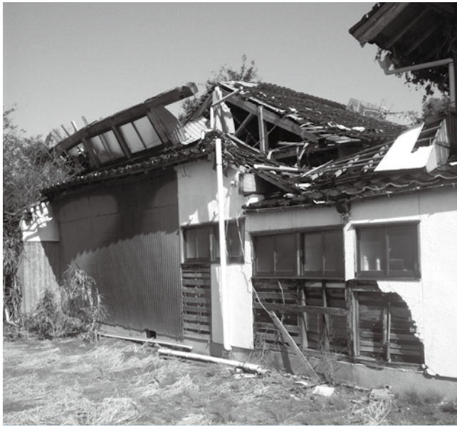
倒壊寸前の民家
