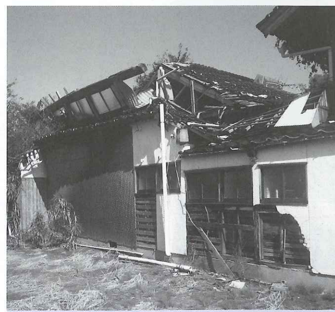
倒壊寸前の民家
