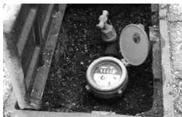
水道メーター
