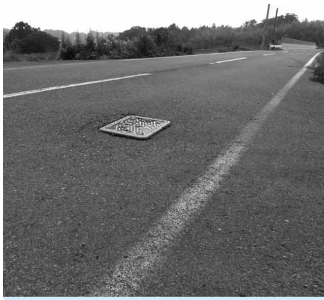
へこんだ町道
