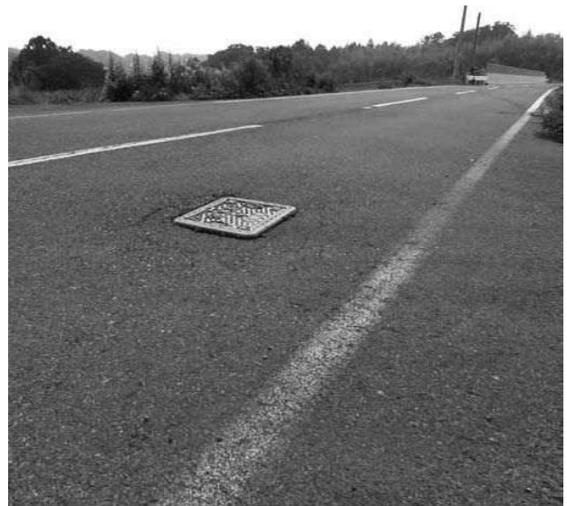
へこんだ町道
