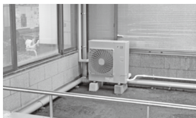
増設されたエアコン
