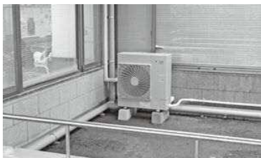
増設されたエアコン
