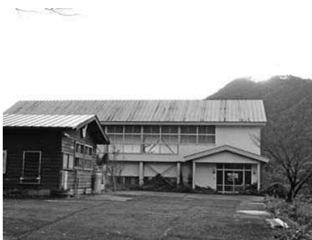
雨漏りで傷む旧香取分校体育館
