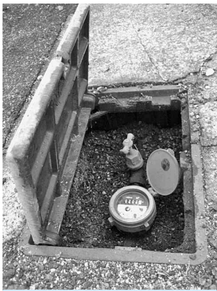
止水栓と水道メーター
