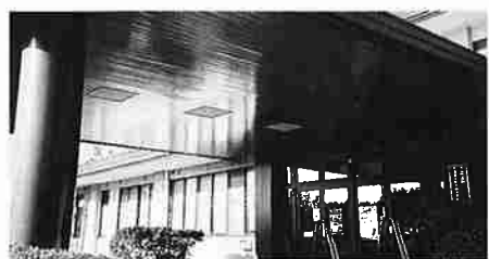
名和トレセン玄関車寄せ アスベストが使われているが天井板があり、危険性はない。
