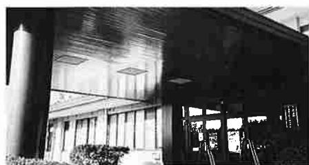
名和トレセン玄関車寄せ アスベストが使われているが天井板があり、危険性はない。
