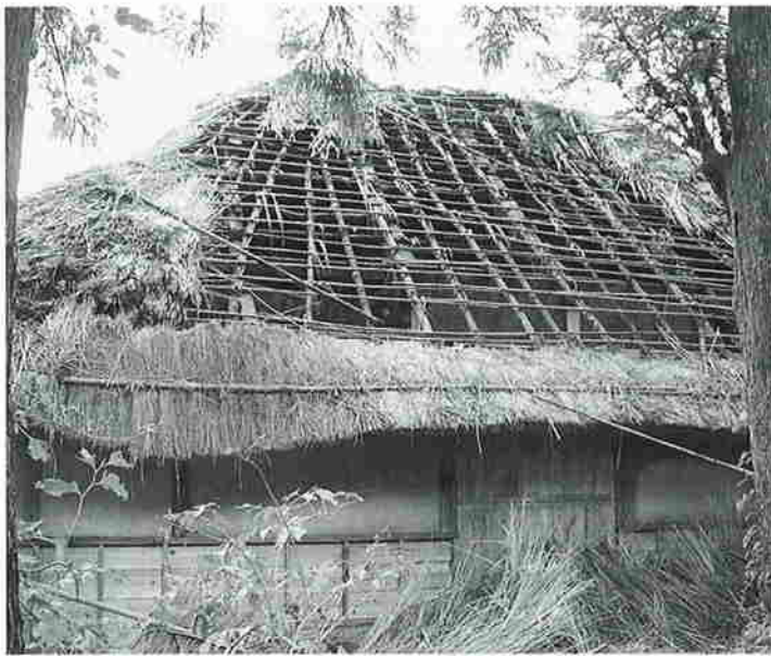
早急な整備が必要な蓮浄院
