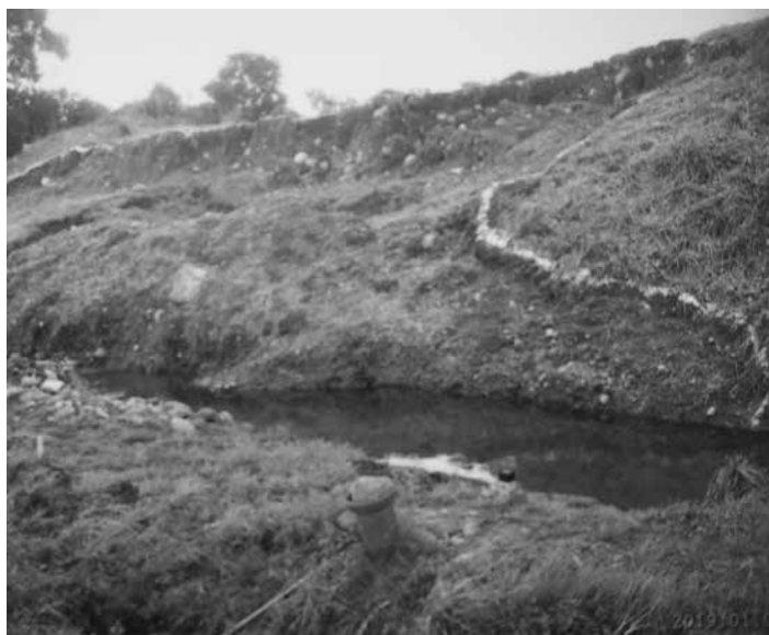
台風 24 号で河川肩の崩れた排水河川
