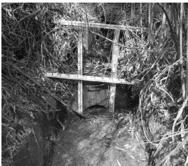
改修が必要な横断暗渠
