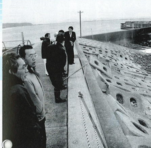
ブロックが陥没した平田漁港を視察
