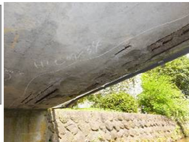
コンクリートの鉄筋露出
