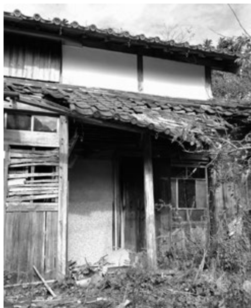
倒壊寸前の空家（写真はイメージです）
