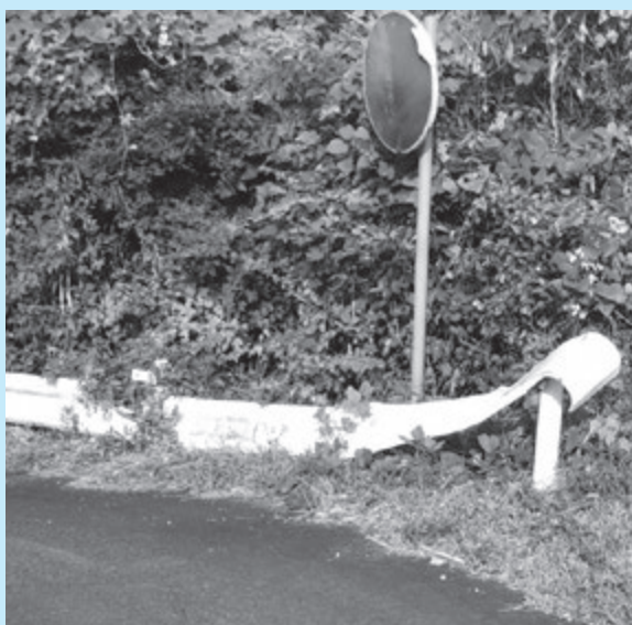
修繕を待つガードレール
