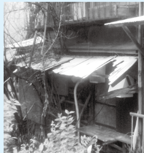
放置された空き家
