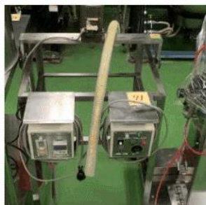
071 混合・沈殿防止攪拌装置付きCタンク
