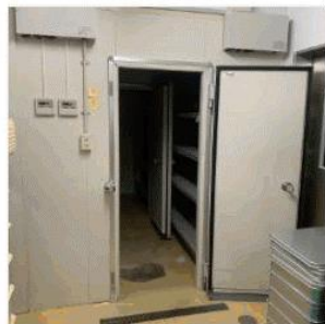
008 009 プレハブ冷蔵庫、冷凍庫
