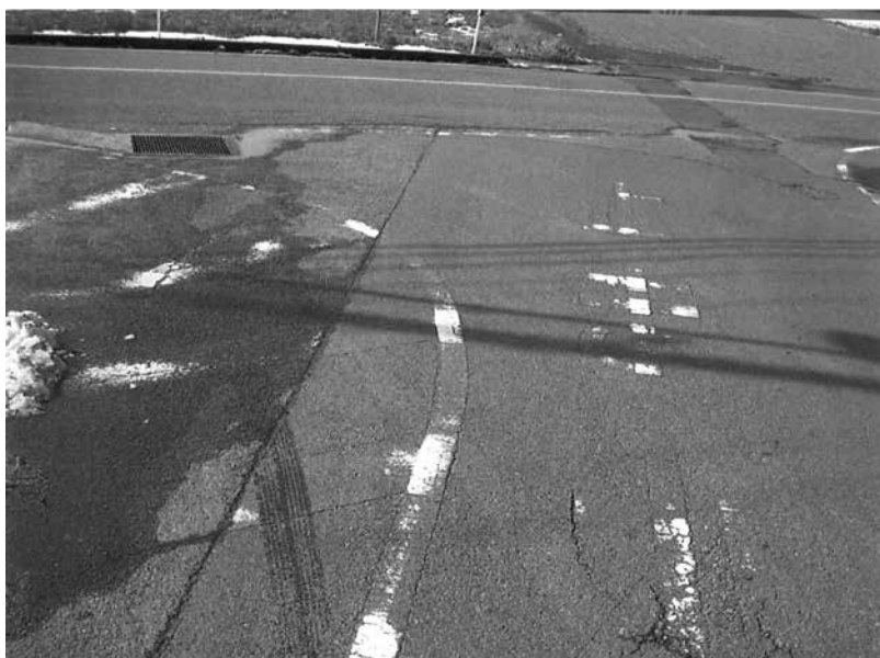
薄くなった道路標示
